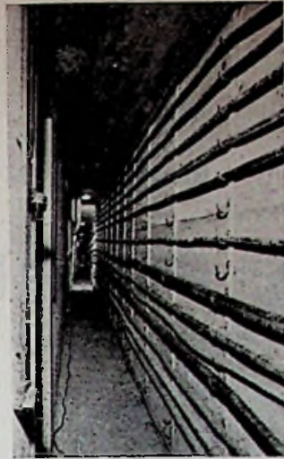
Figuur 12. Leidingtunnel met hoog- en laagspannings- en zwakstroomkabels.
